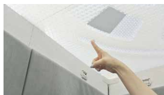
天井の換気口は手で調整できます
